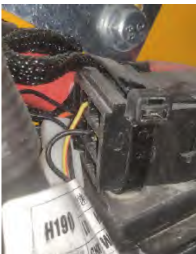
Relæet er placeret til højre.
