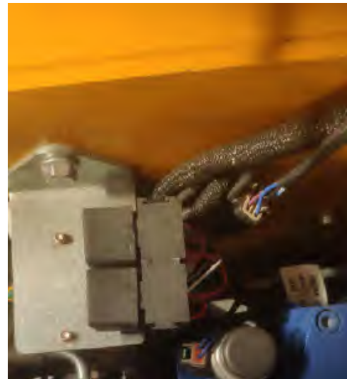
Relæet er placeret til højre.
