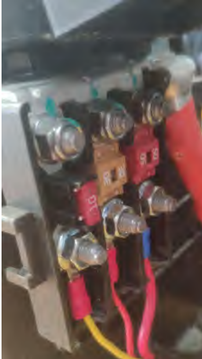
Sikringen er placeret under den positive pol på batteriet.
